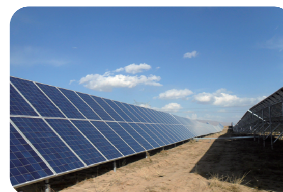
● 中电投山阴50MW项目
