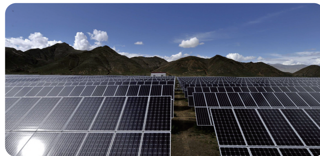
● 特变自建135MW
